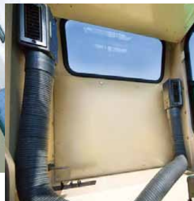
▲エアコンダクト
